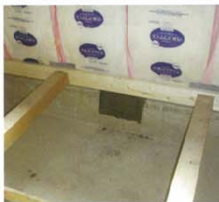
壁内上下の気流止め これがないと断熱材効果なし
